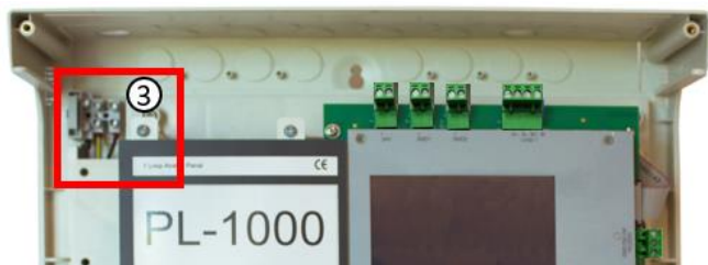
Fig. 14: Conexiones a la red
